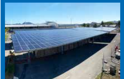
AMBI Energy a réalisé la pose de 7 590 panneaux photovoltaïques sur 8 000 m 2 ombrières, sur le parking de l'aéroport de La Tontouta.
