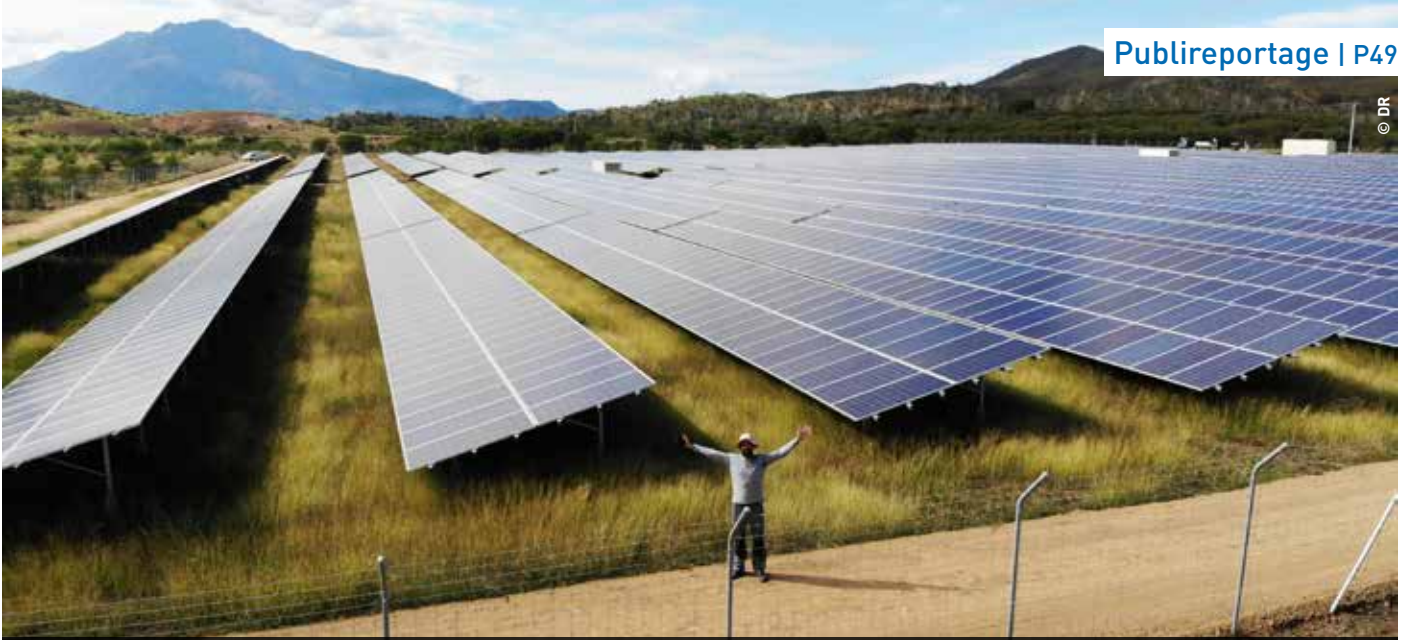
La ferme solaire de Kotabore, à Païta (3,2 MWc), construite par AMBI Energy.
