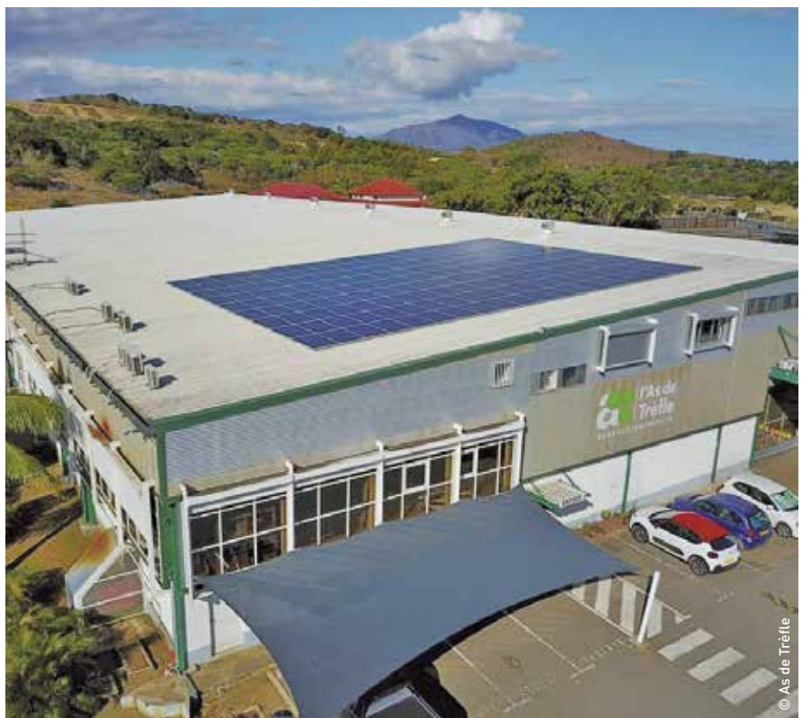
Le dock de l'As de Trèfle est équipé de panneaux photovoltaïques.
