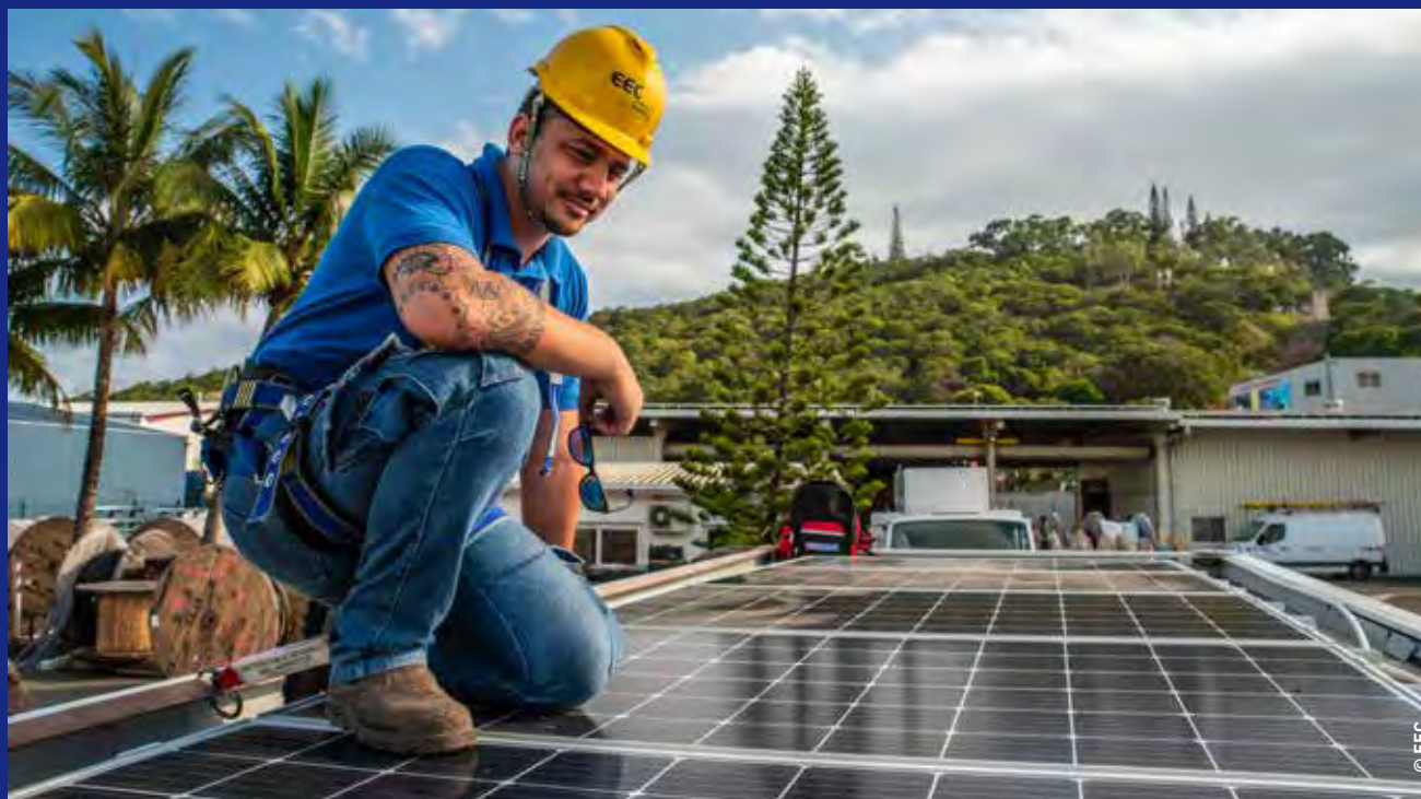
Les installations fleurissent également sur les toits des particuliers, des entreprises et des collectivités.
